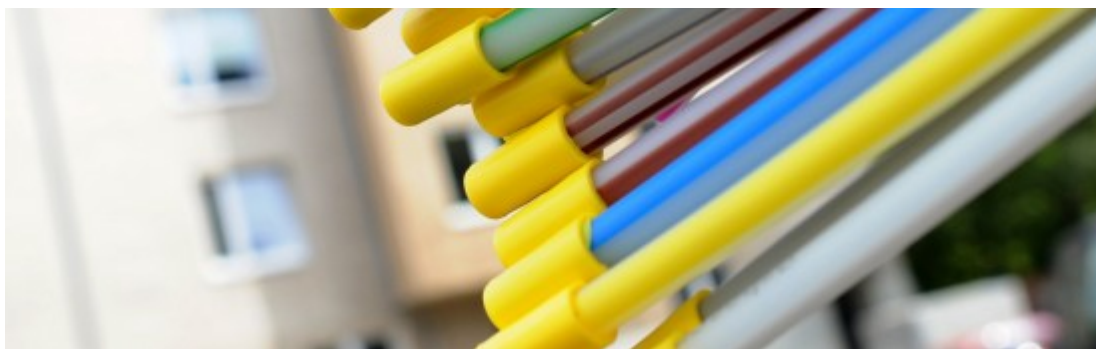
Einzelne Glasfaserkabel der Deutschen Telekom, aufgenommen bei Verlegearbeiten in Hannover. (picture alliance / dpa - Julian Stratenschulte)
